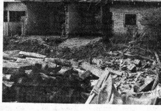
Daños en Bermejo
