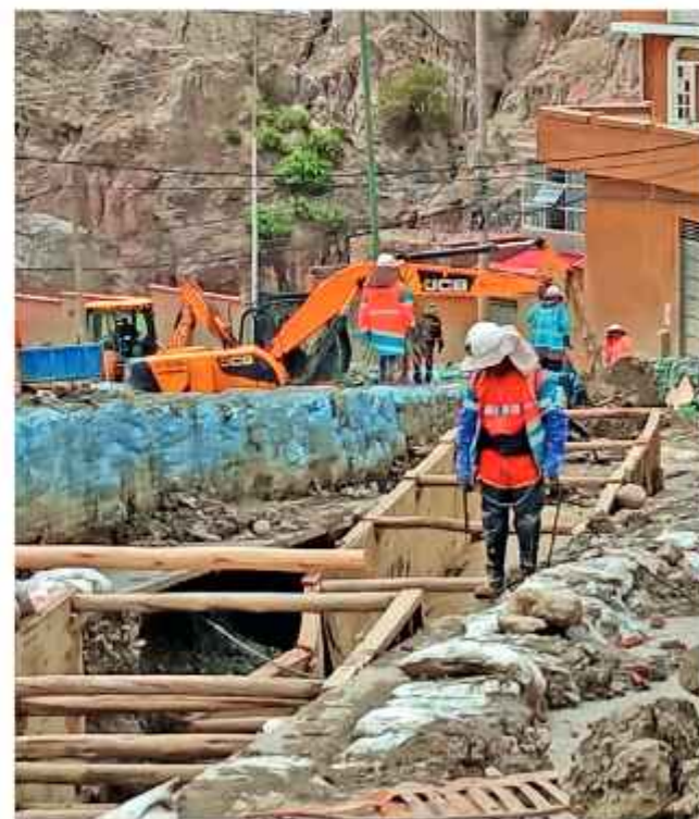
LODO. En Bajo Llojeta, el lodo inundó y causó graves daños.
