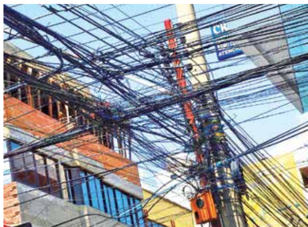
Maraña de cables en la avenida Heroínas, en el centro de la ciudad, en imagen de archivo. ANDIA
