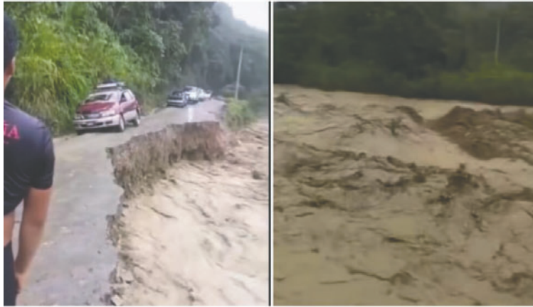
Parte de la carretera entre Caranavi y Guanay afectada por el río /ANF
