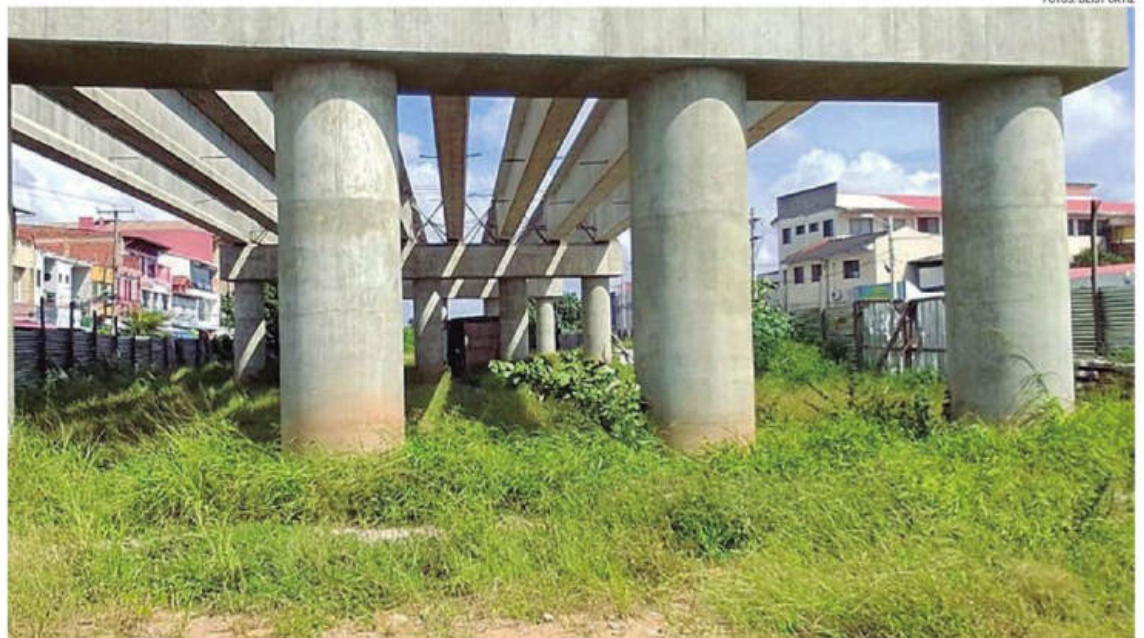
Los matorrales cubren el espacio donde se levanta la estructura en Plan 3.000. La obra está paralizada desde hace varios meses
