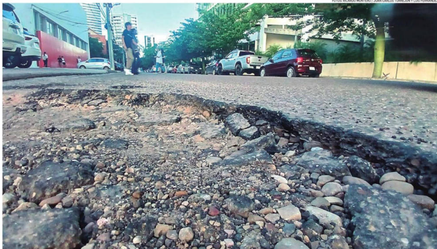
ALGUNOS SON MÁS VISIBLES. Este es uno de los baches que genera inconvenientes en la avenida San Martín y cuarto anillo. El problema se presenta en distintas avenidas y calles de la ciudad
