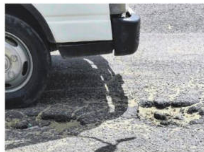
HAY VARIOS EN UNA SOLA VÍA. Para los conductores es difícil evitarlos, ya que muchos están tan juntos que forman hileras de huecos en el asfalto
