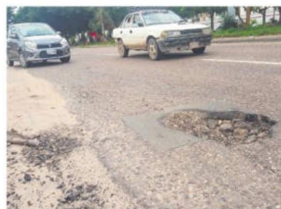
CUARTO ANILLO. Estos huecos se han formado entre las avenidas Paraguará y canal Cotoca
