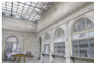
Edificio de Correos se encuentra deteriorado /LA PATRIA
