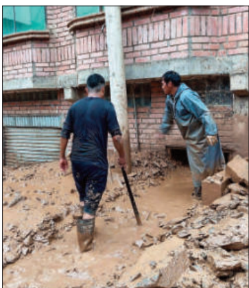
Lodo y rocas ingresaron al sector.
