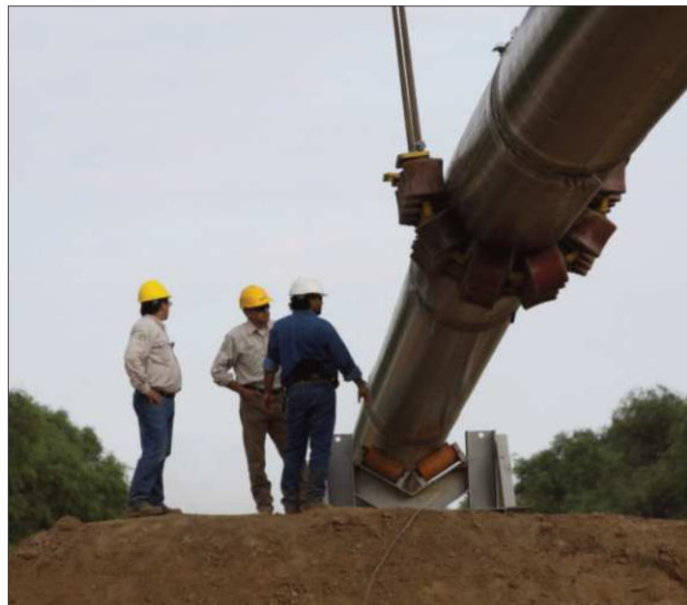
GASODUCTOS. El país cuenta con 9.000 kilómetros de ductos.
