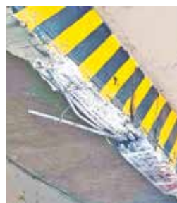
Viga dañada del puente Antezana. D.J.
