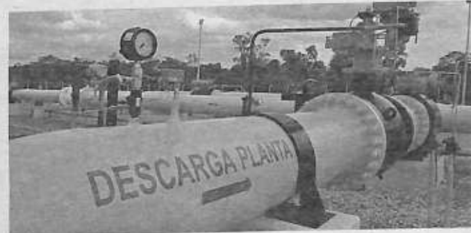
Gasoductos de exportación de Bolivia /YPFB
