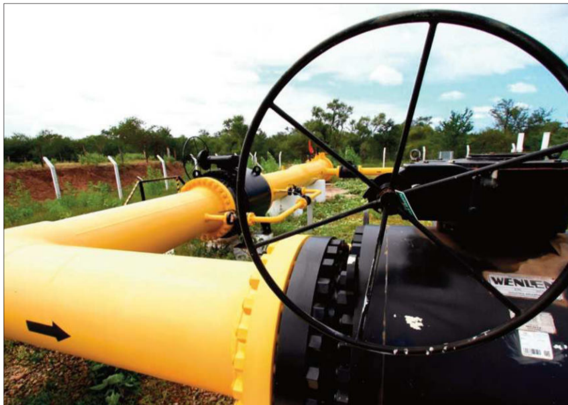
INFRAESTRUCTURA. El gasoducto que permite la exportación de gas natural hacia Argentina.
