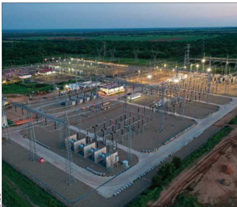
PROYECTO. La subestación Las Brechas instalada en Santa Cruz.
