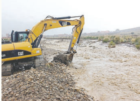
Buscan apoyo nacional y hasta internacional tras derrumbe de varias infraestructuras por inundaciones /GADOR
