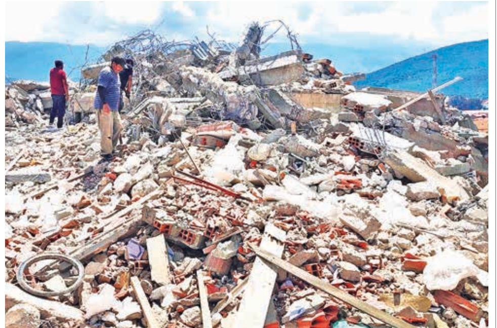
Una de las casas afectadas por el deslizamiento en la OTB Nuevo Amanecer. DANIEL JAMES
