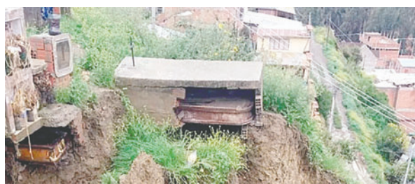
Algunos nichos quedaron colgando tras el deslizamiento /RR.SS.
