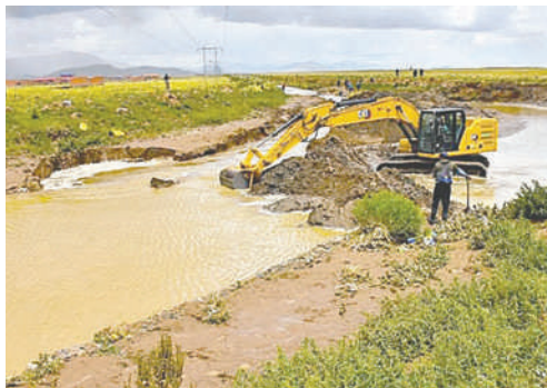
Trabajos de defensivos del río Vinto se ejecutan para evitar desbordes /GAMO
