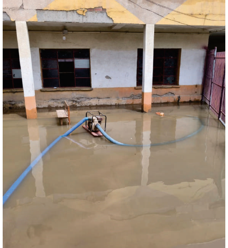
Fuertes lluvias provocaron inundaciones en los patios de las escuelas / DIESD
