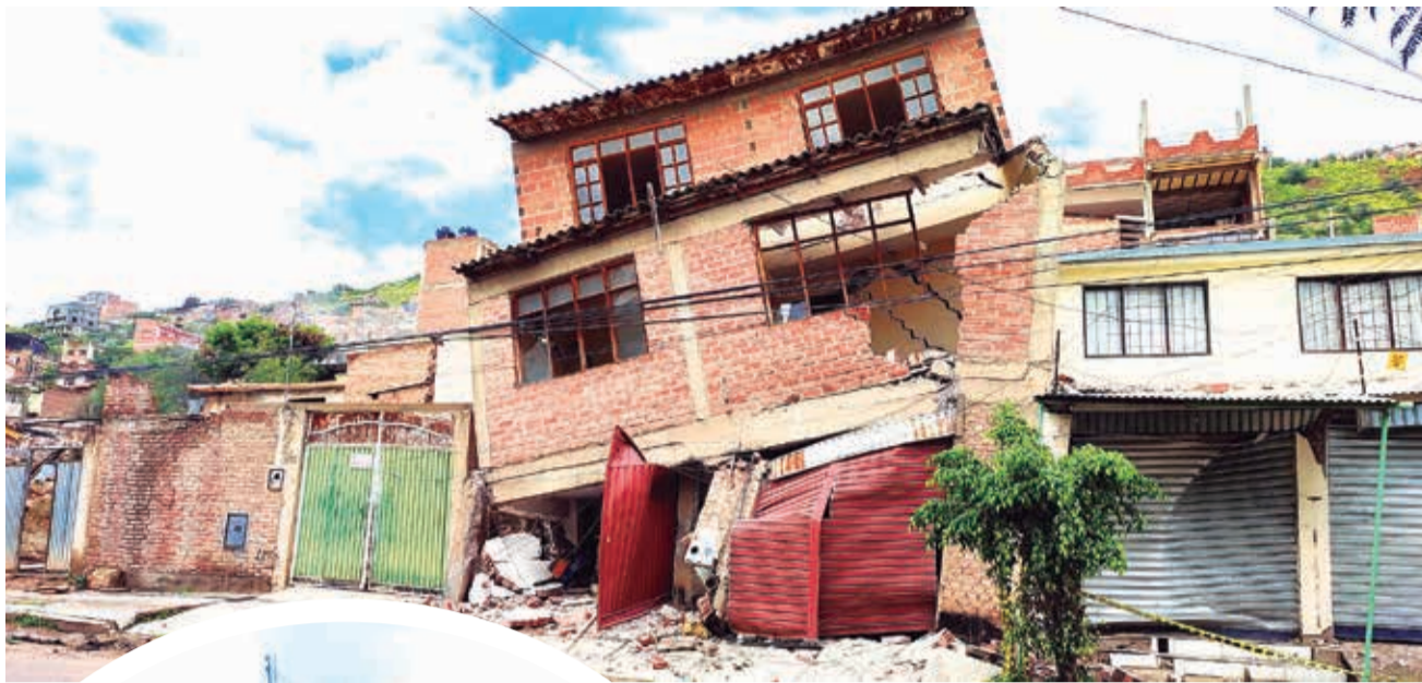
Una de las viviendas que se desploma en la OTB Nuevo Amanecer, cerca del Campo Ferial. FOTOS: DNIEL JAMES
