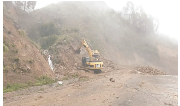
Los derrumbes afectaron la conexión carretera entre Oruro y Cochabamba /ABC
