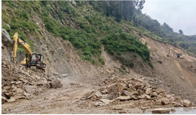
Tráfico en tramo Cochabamba - Bombeo permanece cerrado por trabajos para recuperación de plataforma /ABC
