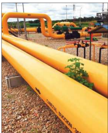
Uno ducto de la estatal.
