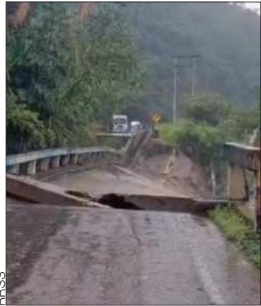
El puente colapsado.
