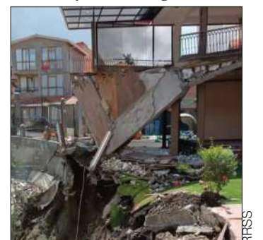
La casa afectada en Jupapina.
