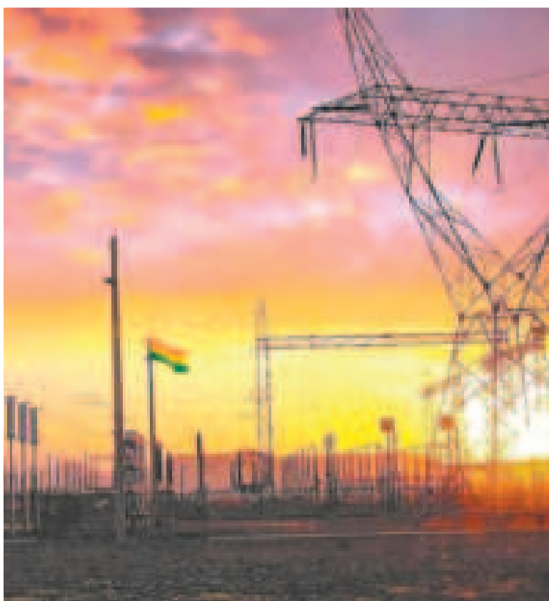
Infraestructura de transmisión de electricidad.
