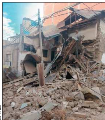
La vivienda desplomada.
