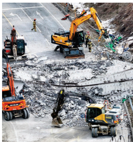
Trabajos de desescombro en el puente derrumbado en Corea del Sur /EFE
