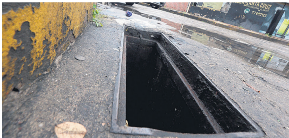
Algunos sumideros están sin la tapa y no tienen ninguna señalización, como este en calle Ballivián
