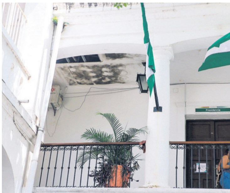
El deterioro es en toda la estructura del edificio, dejando mal aspecto.
