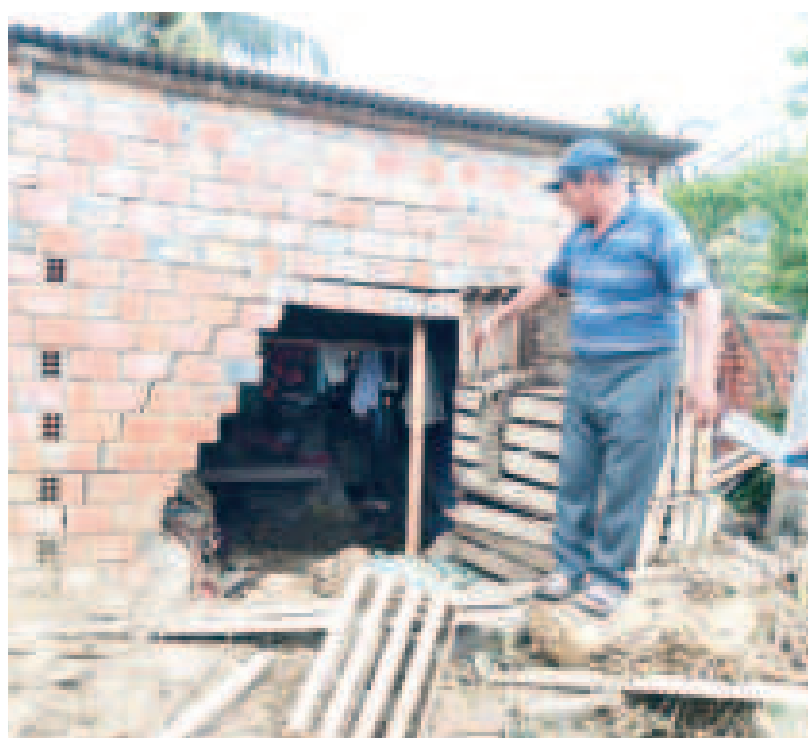
El propietario de una casa muestra los daños en su vivienda a causa de las lluvias.
