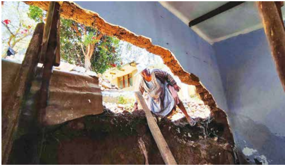
Una de las viviendas deterioradas en la OTB Villa San Miguel ayer. FOTOS: DANIEL JAMES
