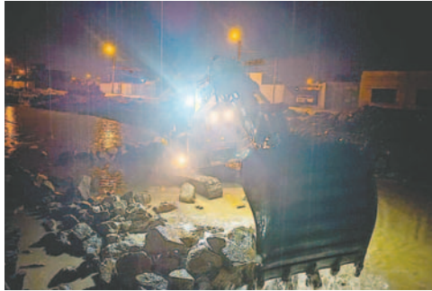
Colapso del canal Tagarete generó zozobra en la ciudad /GAMO
