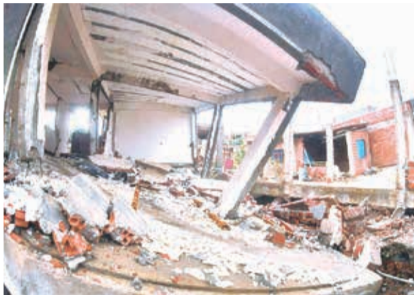
Algunas de las viviendas destruidas por los deslizamientos.
