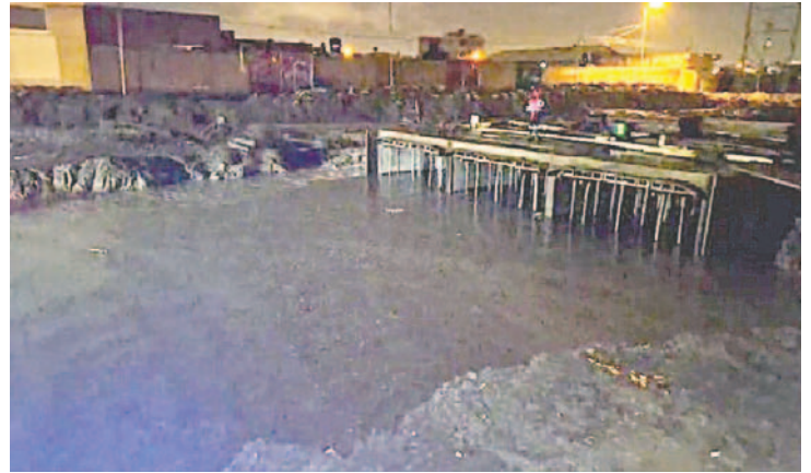
Canal Tagarete colapsó por las intensas lluvias /GAMO
