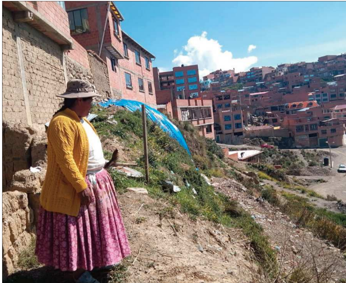
PELIGRO. Seis viviendas de la zona Alto La Portada corren el riesgo de desplomarse debido a las lluvias.
