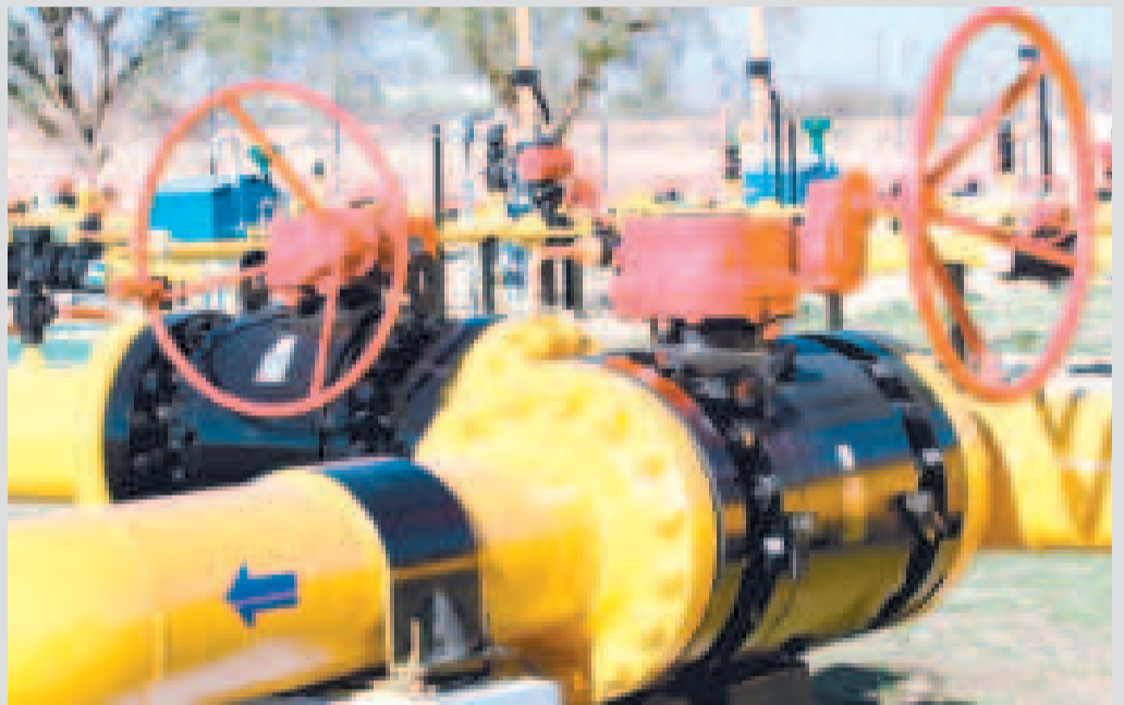
Parte de los gasoductos de Bolivia hacia Brasil.
