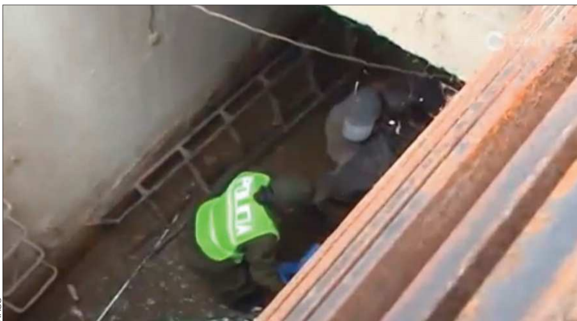
ACCIDENTE. Una persona con discapacidad visual cayó a una cámara de la empresa Delapaz.
