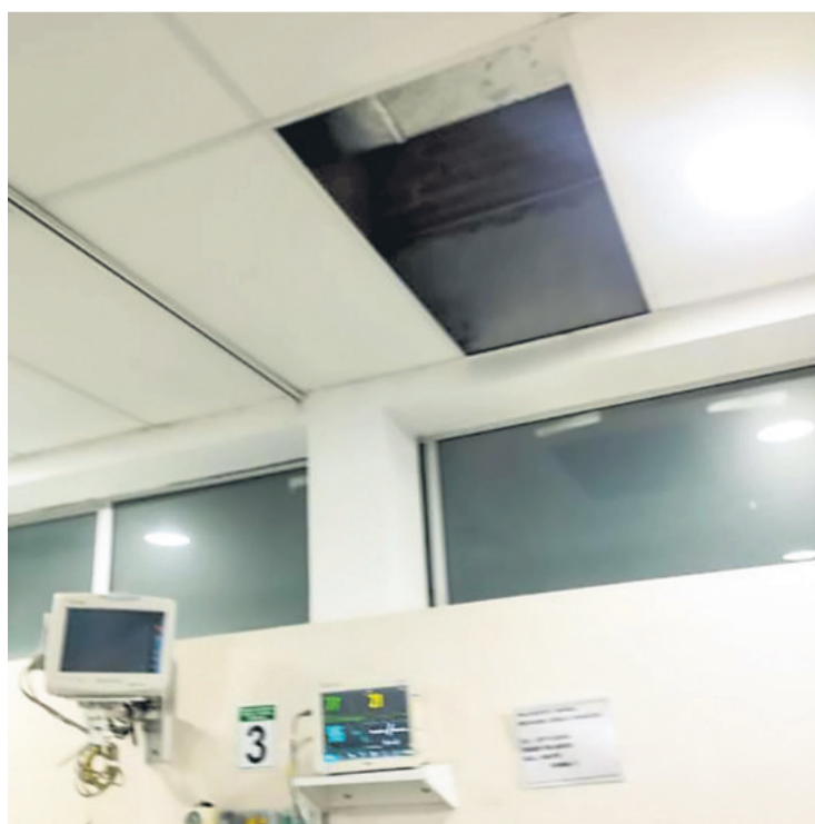
La falta de mantenimiento ocasionó fisuras en la sala de UCI
