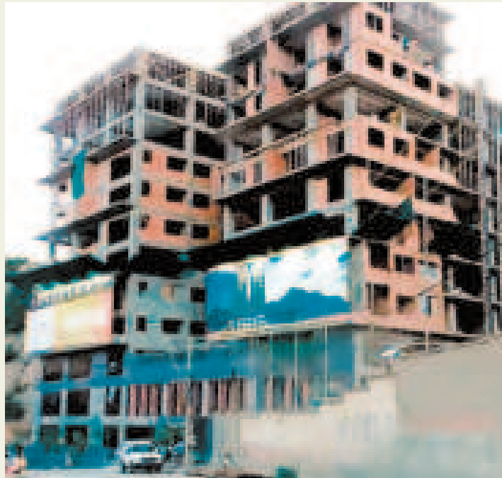
Una edificación paralizada de Las Loritas, en la ciudad de La Paz.
