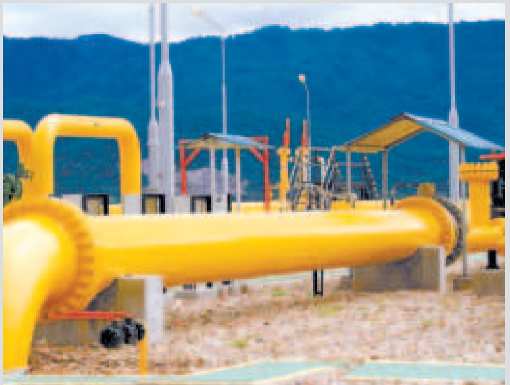
Parte de los gasoductos bolivianos.
