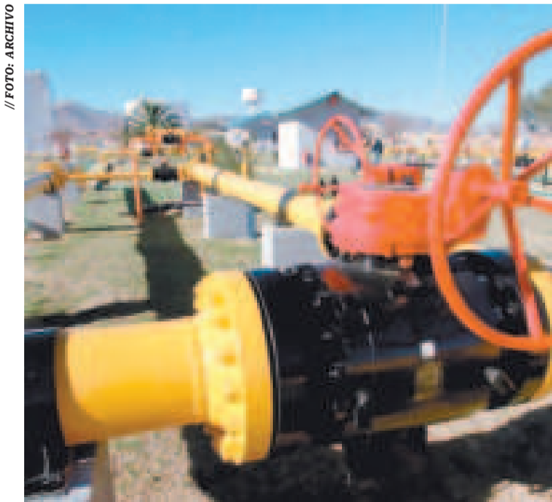
Parte de la infraestructura de ductos de gas del país.
