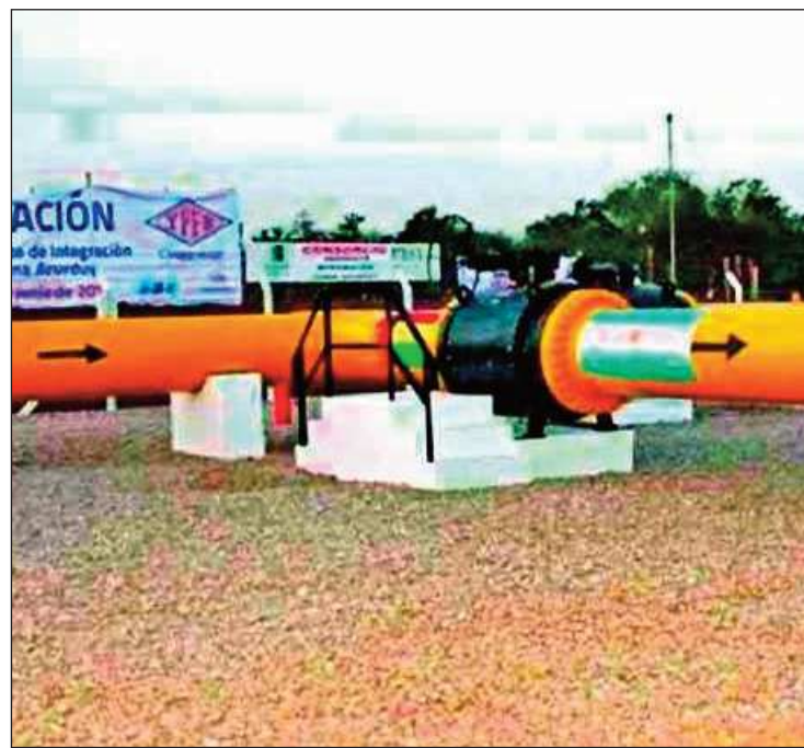
INFRAESTRUCTURA. Un sistema de gasoductos en Bolivia.
