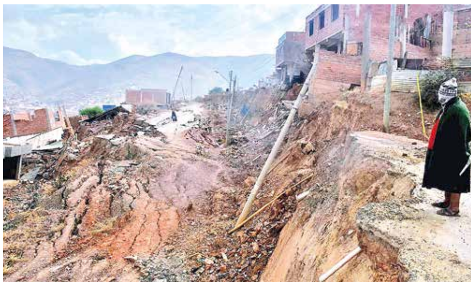
Algunas viviendas afectadas por los deslizamientos en Takoloma, en el sur. JOSÉ ROCHA
