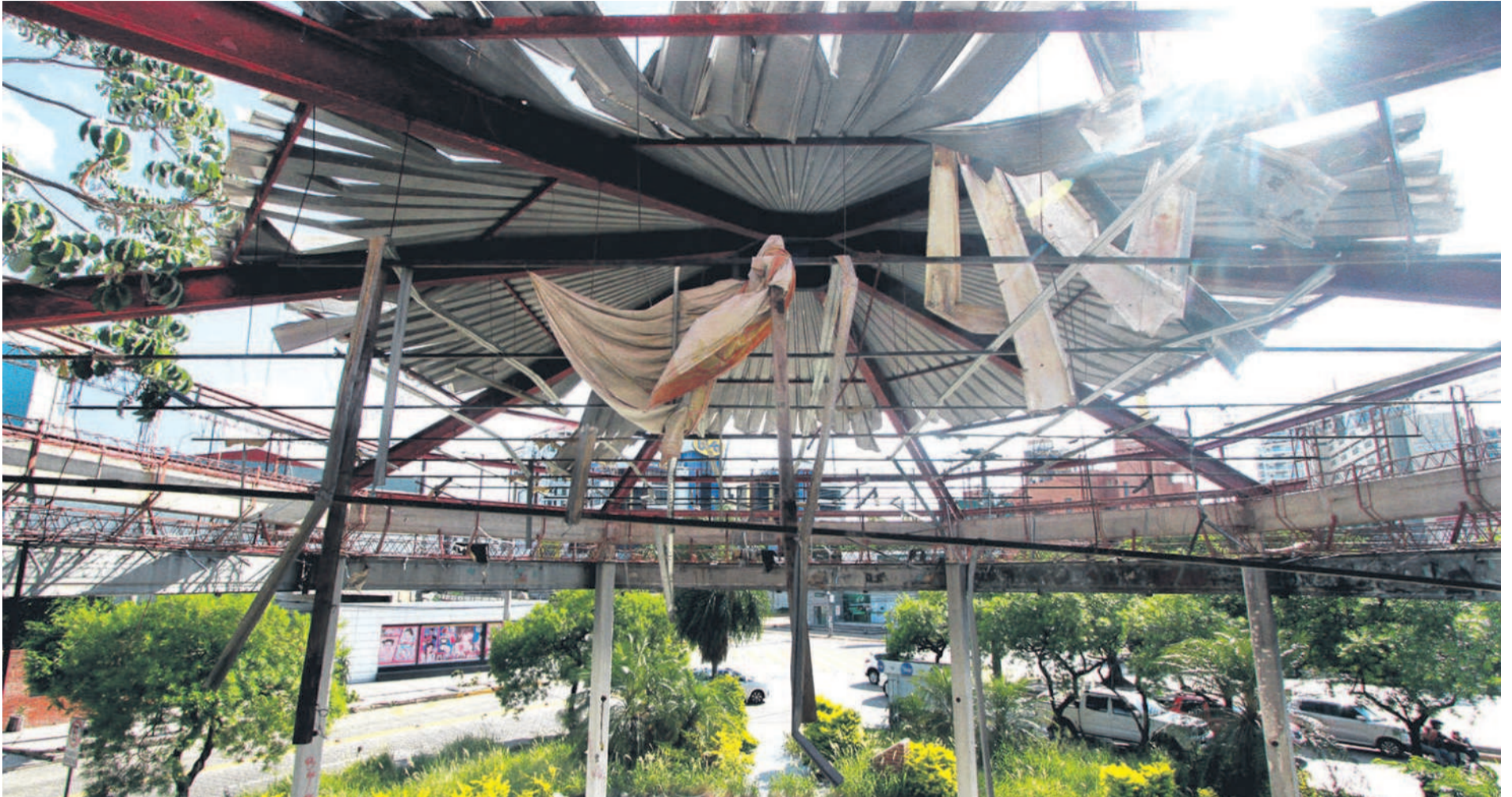
INUTILIZADO. La infraestructura del edificio quedó destrozada y no puede ser reparada porque ha tenido un daño estructural. La Fiscalía funciona en otra oficina y nadie se ocupa de esta construcción
