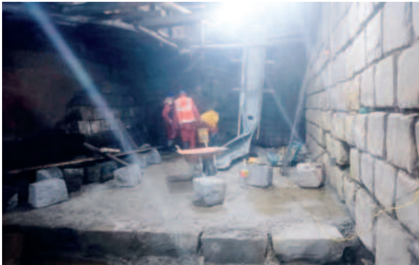
Obreros en el interior de la bóveda del río Choqueyapu, en San Francisco.
