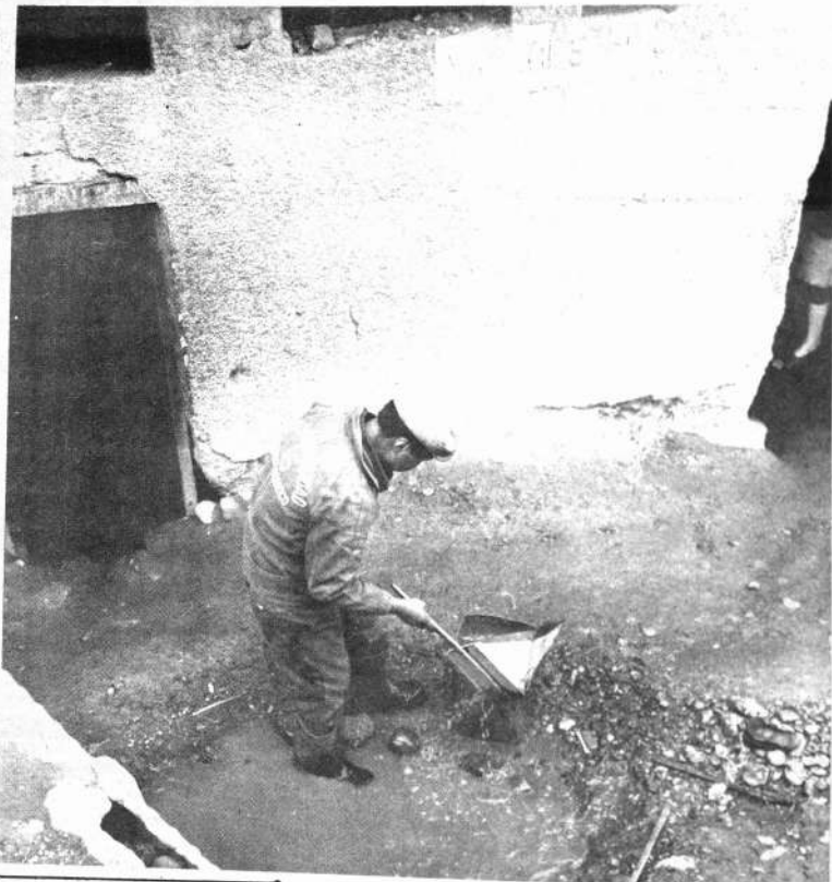
UN TRABAJO HEROICO DE VERAS. Este obrero municipal recoge aguas servidas que se acumulan sobre la calle y utiliza para "lavar" el precario mingitorio que está al fondo. ¡Trabajo difícil y... peligroso!
