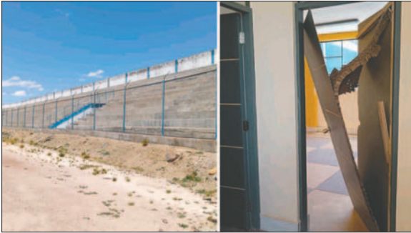
El deterioro por la falta de uso y el paso de los años es evidente
