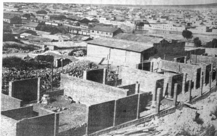
ORURO.— En primer plano, los trabajos de construcción del edificio con que contará el Colegio "Antonio José Sainz" de esta ciudad. Su conclusión está prevista para el mes de julio.
