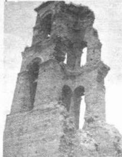
Estado actual de la torre de la Iglesia de Paria.
