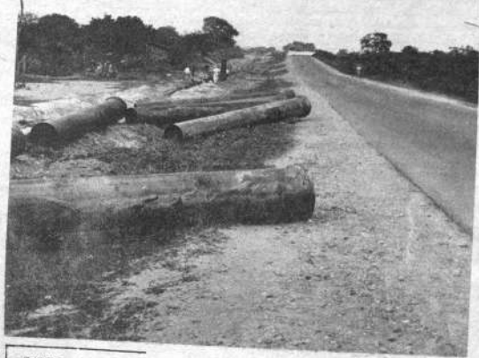
SANTA CRUZ — La avenida de Circunvalación será pronto uno de los atractivos cruceños. Los trabajos de asfaltado se encuentran muy avanzados, como puede apreciarse en la fotografía.
