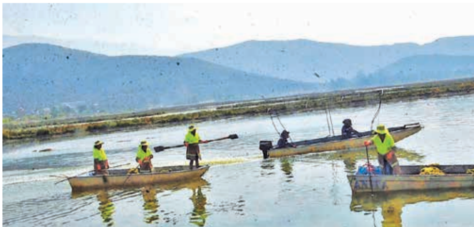
Los trabajos de limpieza en la laguna Alalay, cuyo caudal disminuye. FOTOS: HERNÁN ANDÍA
