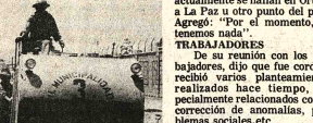
REHABILITACION. Aprovechando una tregua dejada por la época invernal, la Alcaldía de Cochabamba dispuso el trabajo de rehabilitación de la avenida René Barrientos Ortuño, cuyo capa asfáltica estaba deteriorada.
